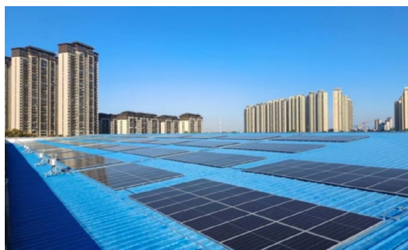
铜陵厂区已建成的光伏项目
